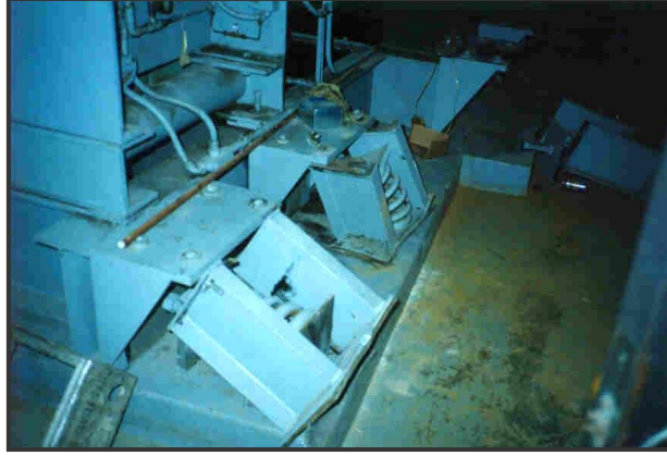
Şekil 9. Sismik izolatörleri yanlış seçilmiş ve yanlış monte edilmiş (kaideye bağlanmamış) bir soğutma grubunda, deprem sonrası meydana gelen hasar
