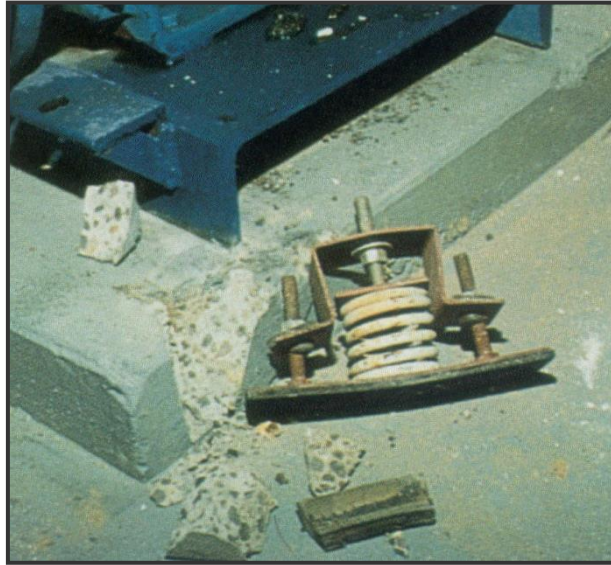
Şekil 12. Sismik izolatör ile kaide arası bağlantıdan kaynaklanan hasar
