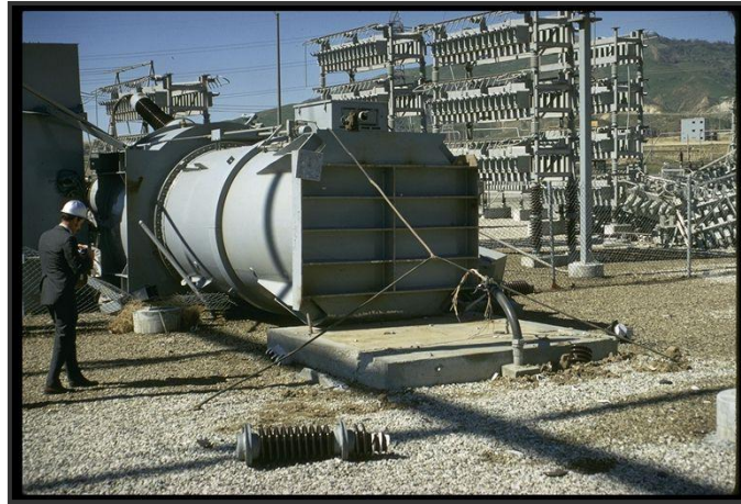
Şekil 3. Deprem koruması olmayan bir trafonun deprem sonrasındaki hasar oluşumu
