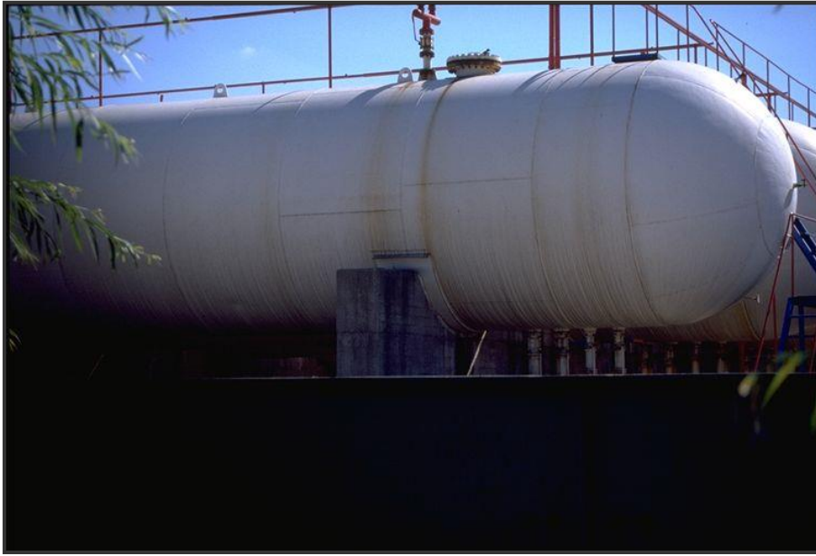
Şekil 5. Deprem koruması olmayan bir tankın deprem sonrasındaki hasar oluşumu
