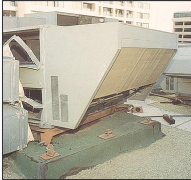
Şekil 8. Titreşim yalıtımı yapılmış ancak deprem koruması olmayan ekipmanlarda hasar oluşumu
