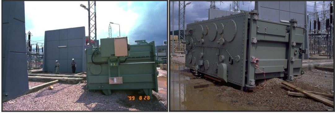
Şekil 10. Deprem yüklerine karşı sınırlama yapılmamış olan trafolar devrilerek kullanılamaz hale gelmişlerdir
