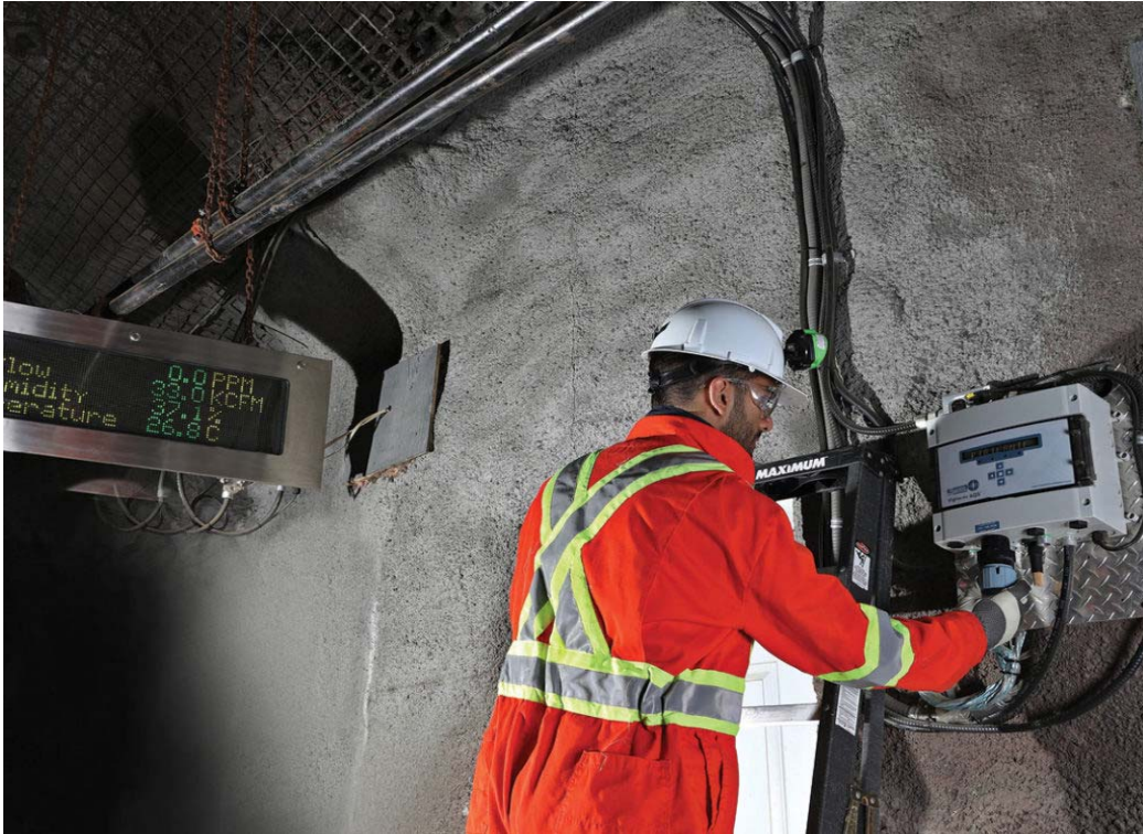
Şekil-9 Atmosfer izleme istasyonu ve maden havalandırma bilgilendirme ekranı. [31]
