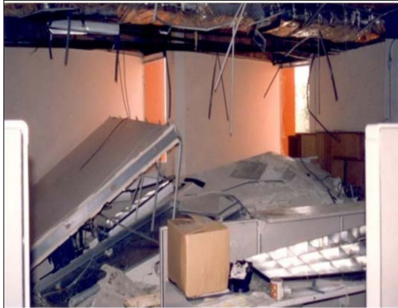
Resim 1. Asma tavan hasarı, Northridge 1994 [3]
