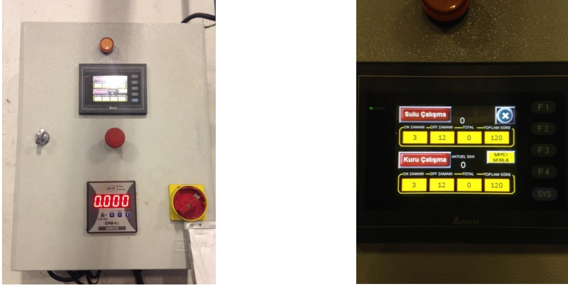
Resim 1. Elektrik panosu-Kontrol ekranı
