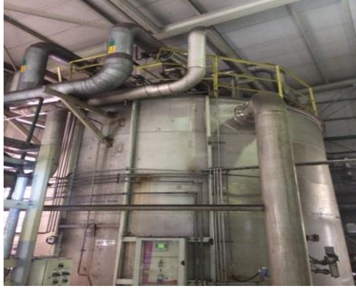
Şekil 9. Tesisteki saf su tanklarının genel bir görüntüsü.
