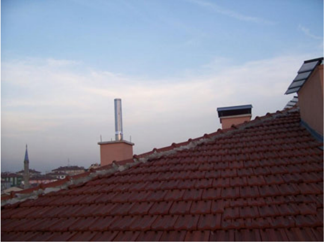
Şekil 71. Çatılarda mahya seviyesi altında kalınması, ters rüzgar akımları sebebiyle baca tepmeleri ve çekiş problemlerine yol açar.
