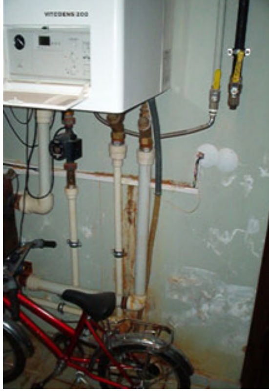
Şekil 75. Mevcut sorun : Paslanma
