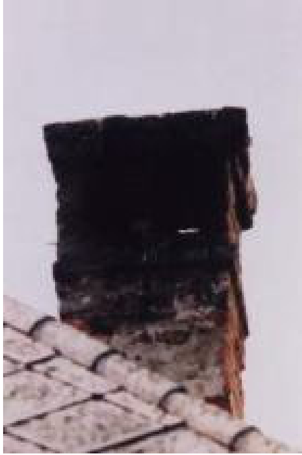
Şekil 70. Uygun olmayan baca malzemeleri kısa zamanda deforme olarak bacanın çökmesine neden olmaktadır.
