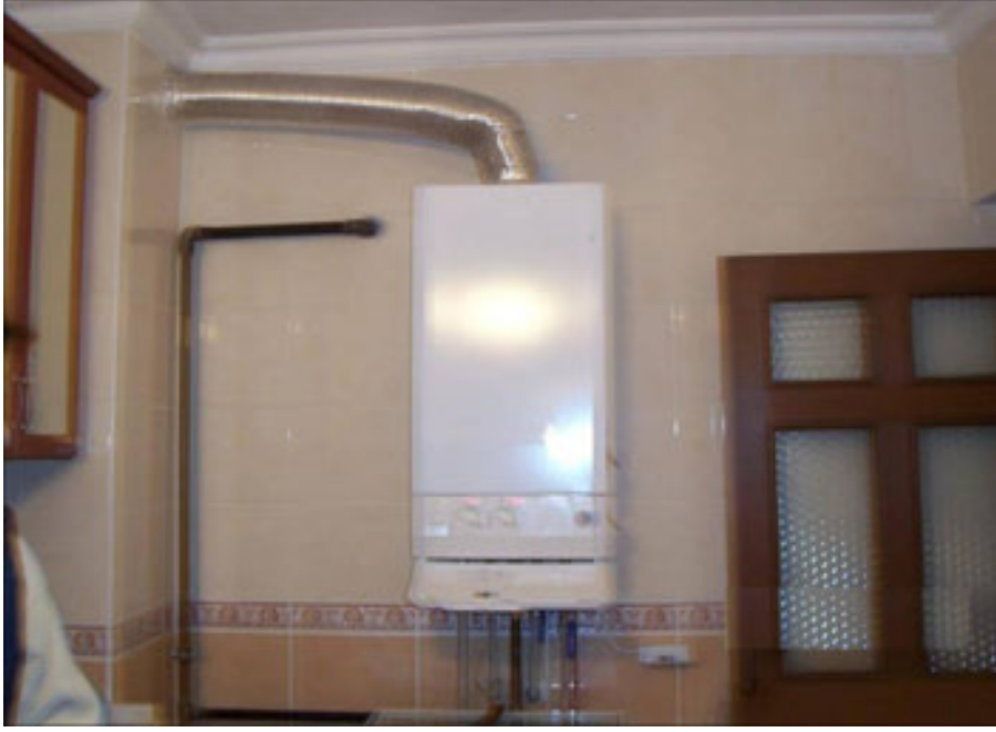
Şekil 52. Gereğinden uzun tutulan yatay mesafe ve hızlandırma mesafesine dikkat edilmeden yapılan bir uygulama.
