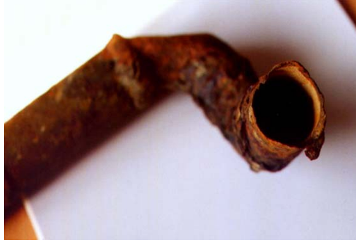
Resim 5. Kopan boru ucu
