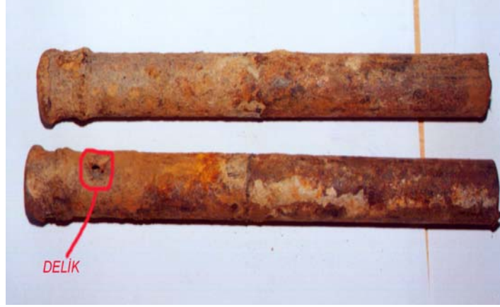
Resim 6. Çukurcuk korozyonu sonucu boruda oluşan delik
