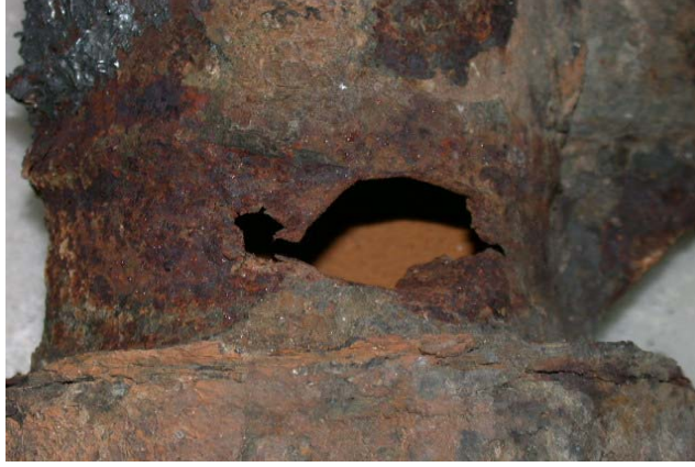
Resim 8. Çukurcuk korozyonu sonucu oluşan delik
