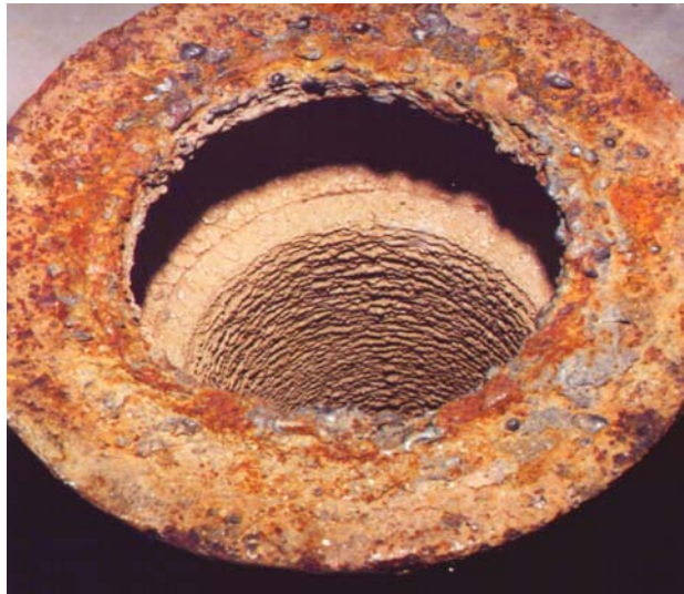
Resim 1. Kompensatörün iç kısmında oluşan kabuklaşma
