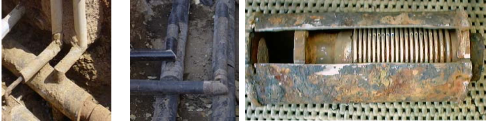
Şekil 6. BNJBIS'te meydana gelen su kaçaklarının ana nedeni
